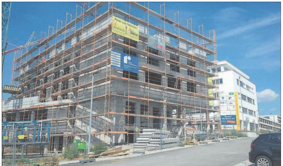
Noch ist das Holiday Inn im Rohbau. Doch nimmt das Gebäude neben dem Gesundheits- und Dienstleistungszentrum (rechts im Bild) täglich mehr Gestalt an. Nächsten Sommer kann das Patienten- und Tagungshotel in Betrieb gehen. Foto: Ralf Trautwein
